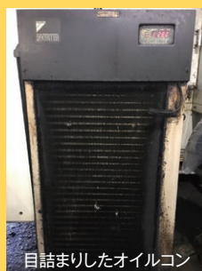
目詰まりしたオイルコン
